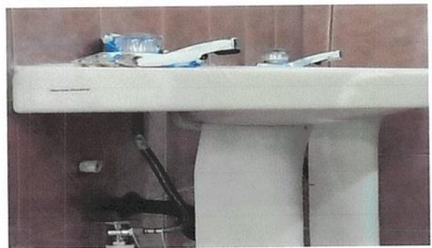
FOTO 2: LAVAMANOS EN MALAS CONDICIONES
