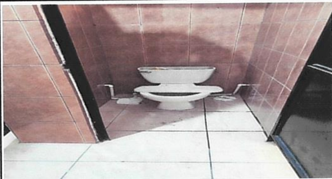
FOTO 1: INODOROS EN MAL ESTADO
