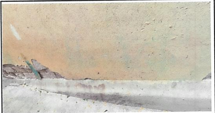
FOTO 4: IMPERMEABILIZACION DE PARED EN MAL ESTADO
